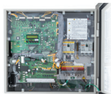
運転/停止、設定変更、表示確認はPCS本体で完結 外部機器(コントローラ等)は不要
